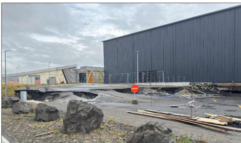
Figura 66 – Registros de edificação interditada e evacuada em Grindavik.
