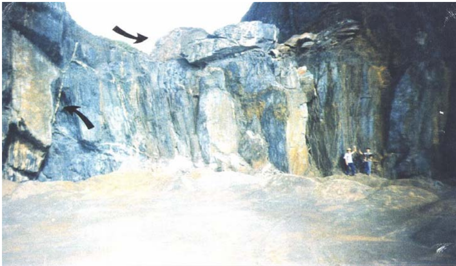
Figura 2.6 - Talude 01, mapeado na Mineração Rio Bravo. Constitui-se de itabirito mole, intercalado por blocos de itabirito duro delimitados pelas superfícies de descontinuidade. Observa-se a ocorrência de ruptura planar, segundo a xistosidade, e a presença de blocos parcialmente sem apoio, na altura da crista do talude, ocasionados, provavelmente, por ruptura no banco superior da mina.
