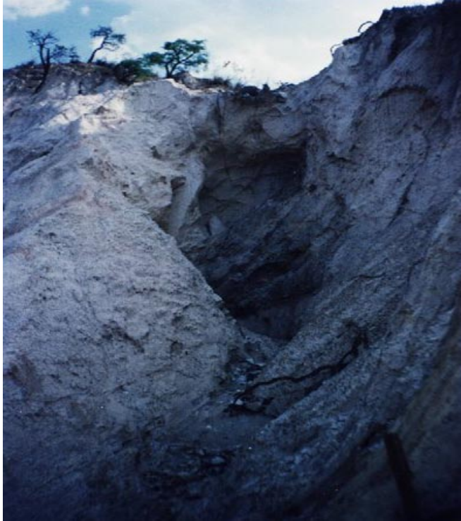
Figura 4.15 – Ravina surgida em talude em xisto multíssimo alterado, na altura do bairro Jonas Veiga, BH. Algumas superfícies de xistosidade ainda estão nítidas. No momento do levantamento , o talude se encontrava totalmente seco.
