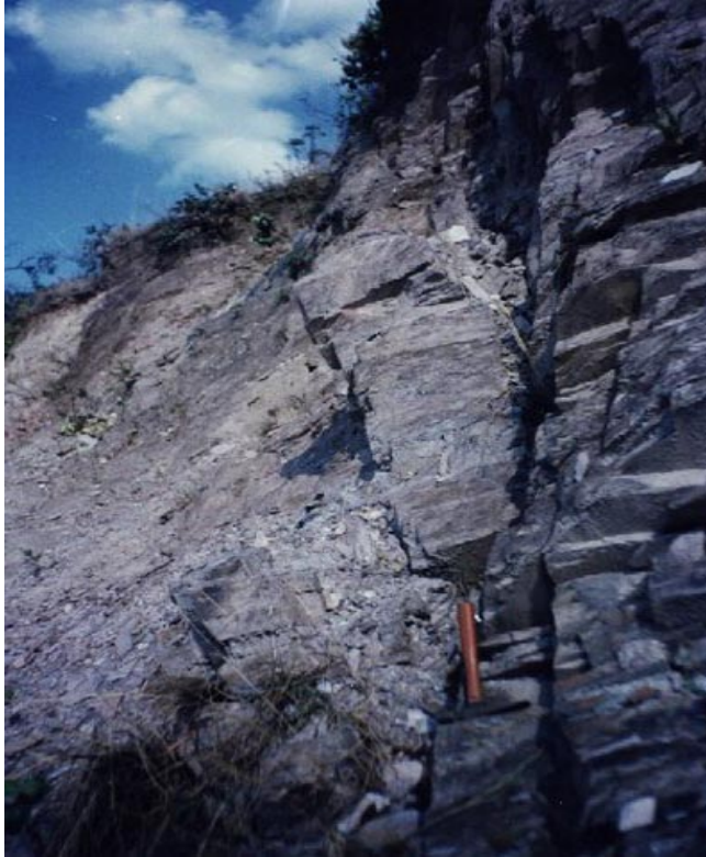
Figura 4.14 – Colapso de bloco em talude em quarzo-xisto, na altura do bairro Pirineus, BH. Nota-se, na porção direita da foto, como a xistosidade mergulha para dentro do talude, favorecendo o surgimento do colapso, no contato com superfície de descontinuidade (fratura) quase vertical.
