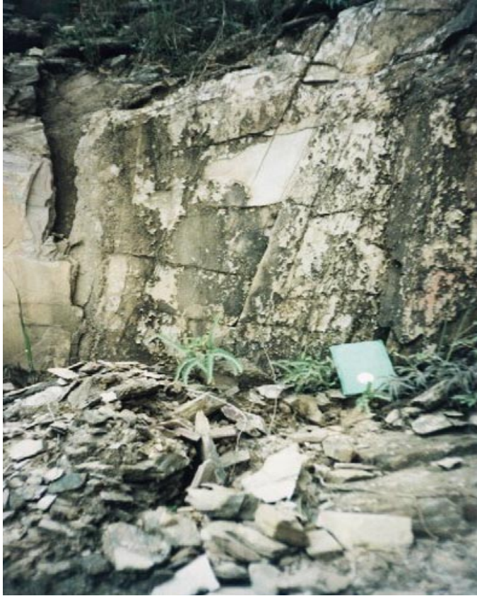
Figura 4.12 – Detalhe para ruptura planar em talude construído em xisto, próximo ao bairro Jonas Veiga, BH. O padrão de fraturamento é bastante nítido. Notam-se placas centimétricas (algumas cobertas por limo) soltas ao pé do talude. Na porção esquerda da foto, nota-se uma fenda, provavelmente originada pela ação da água das chuvas.
