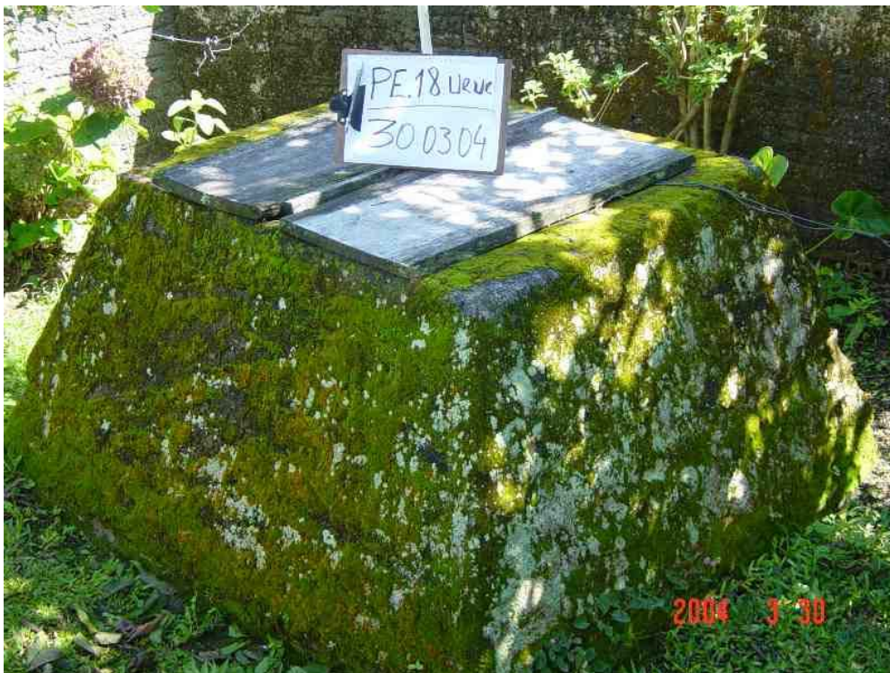
Figura nº 55 - Coordenada 658.960E/6.845.277N, município de Urussanga, poço escavado com cimentação quase que somente acima do nível do terreno, precariamente tamponado.
