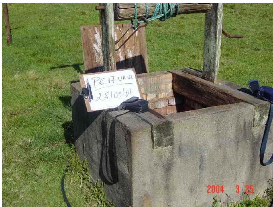
Figura nº 54 - Coordenada 667.413E/6.845.336N, município de Urussanga, poço escavado com cimentação quase que somente acima do nível do terreno.
