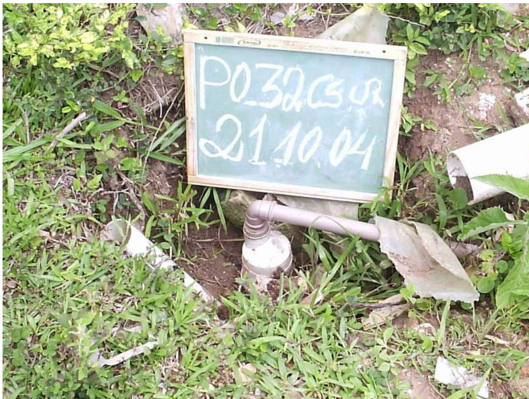
Figura nº 53 – Coordenada 670.178E/6.836.302N, município de Cocal do Sul, poço ponteira sem proteção sanitária, abaixo do nível do terreno.
