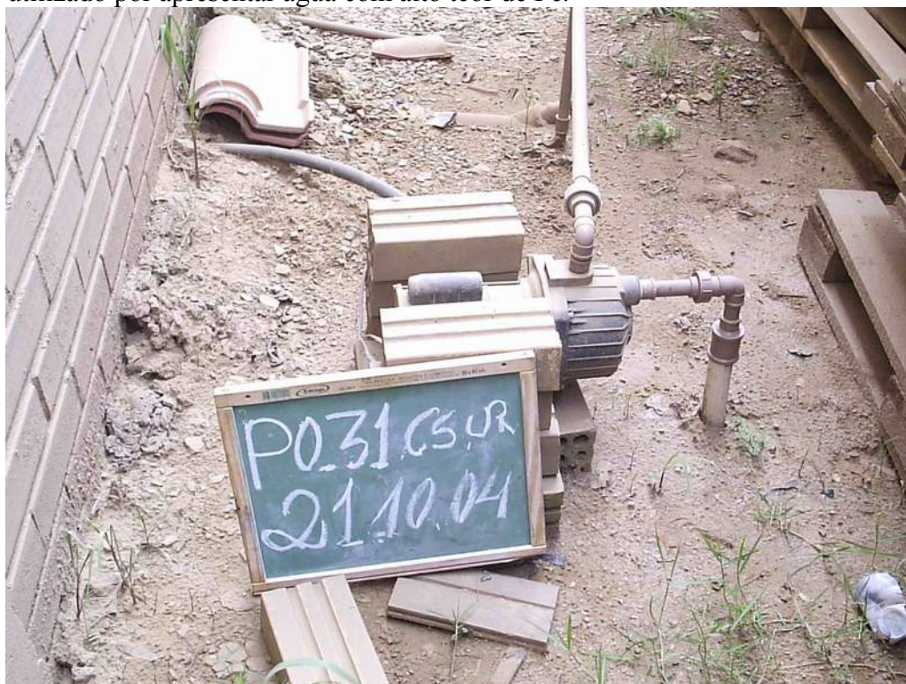
Figura nº 52 - Coordenada 670.591E/6.836.365N, município de Cocal do Sul, poço ponteira sem proteção sanitária.
