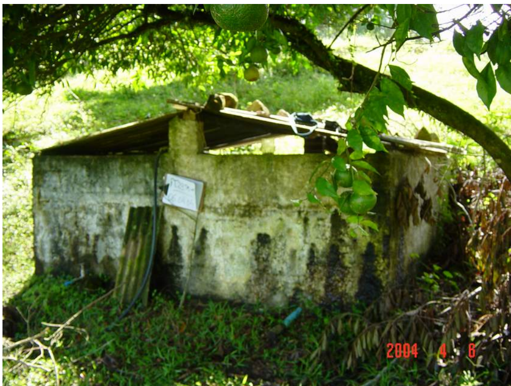
Figura nº 59- FT-29 TM-UR Coordenada 672.060E/6.836.790N, fonte natural cadastrada no município de Treze de Maio. Observa-se a proteção efetuada, mas inadequada.
