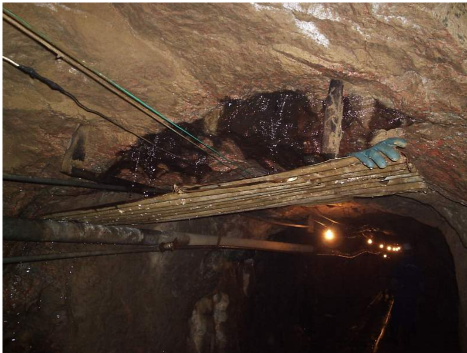
Figura nº 26 - Percolação de água em fratura , nível 250 metros da mina de fluorita.
