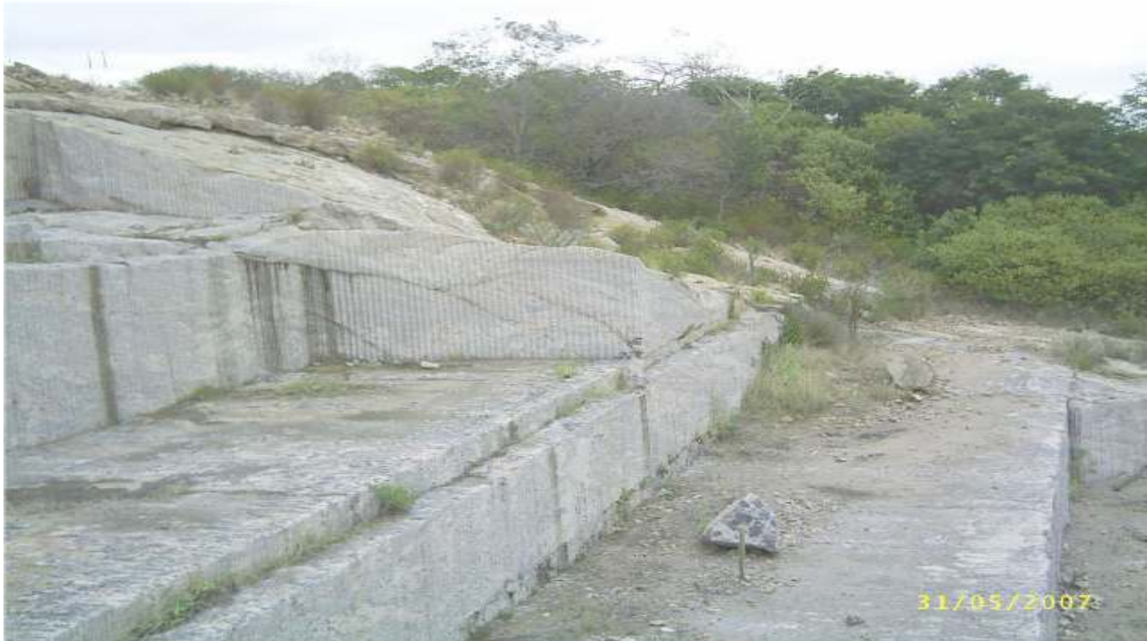
Foto 3.5 - Visão da frente de lavra do migmatito róseo-avermelhado da Pedreira Sítio Jaú, onde se nota-se a presença de fraturas horizontais geradas por alívio de carga.
