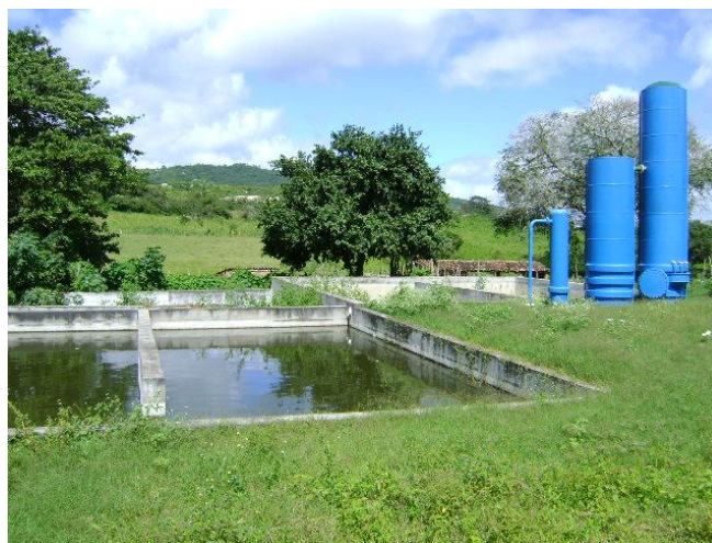
Figura 53 – RAFA instalado no Distrito de Mutuca - Pesqueira. Fonte: Autor.
