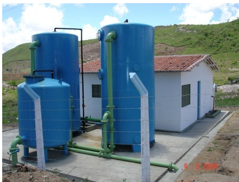
Figura 58 - Estação de Tratamento de Água (ETA) compacta instalada no reservatório de Jenipapo - Pesqueira. Fonte: Autor.
