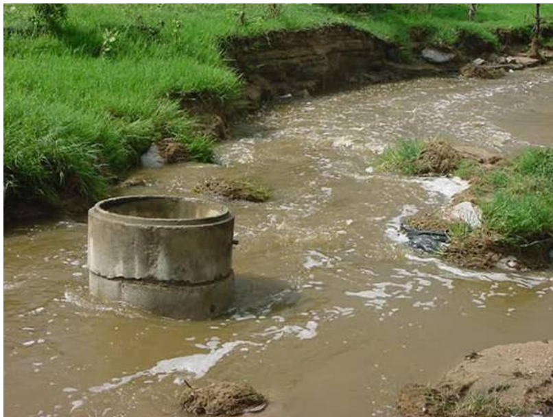
Figura 68 – Erosão verificada na Barragem Cafundó I no distrito de Mutuca - PE. Foto: Autor.
