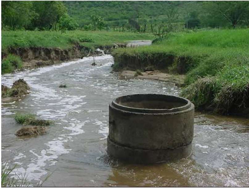
Figura 67 - Voçoroca causada pela força das águas na Barragem Cafundó I no distrito de Mutuca - PE. Foto: Autor.
