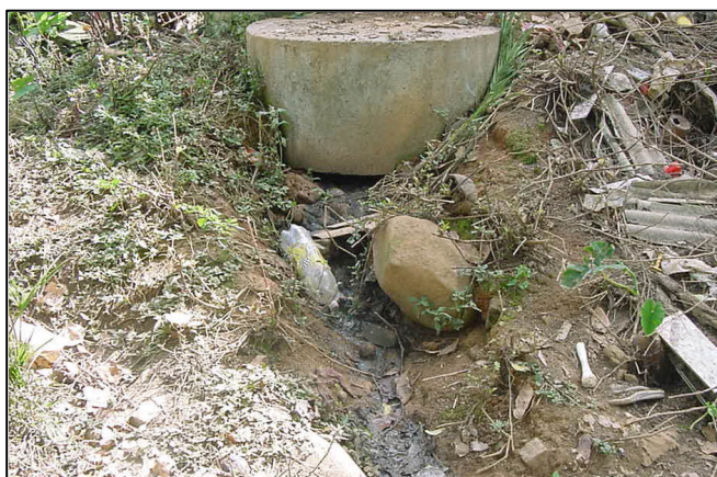
Fig. 35 - Fossa séptica onde é armazenado o esgoto sanitário proveniente da população do distrito de Dr. Loretti com vazamento.
