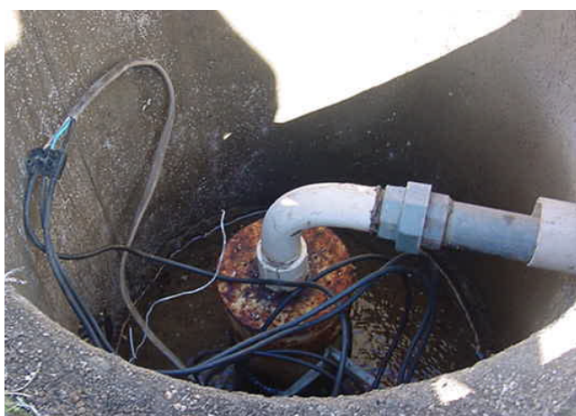
Fig. 32 - Poço tubular profundo. Jorrante. CIEP de Trajano de Moraes.
