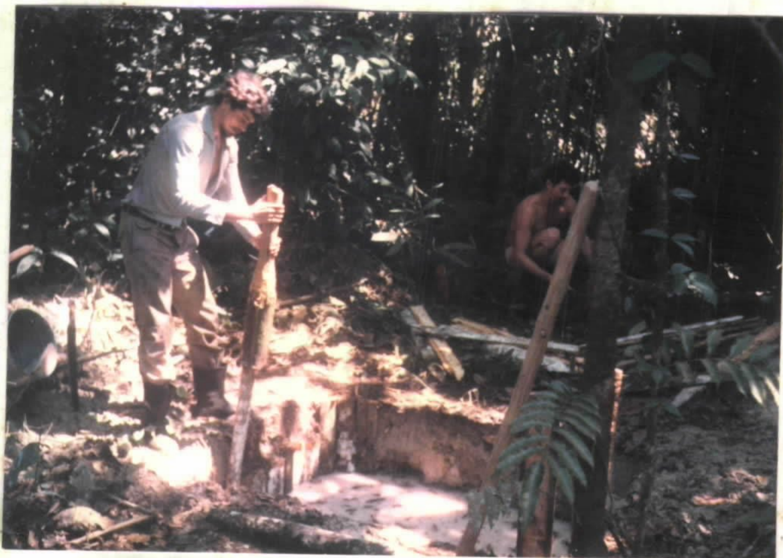
POÇO REVESTIDO NO IGARAPÉ JABOTA
