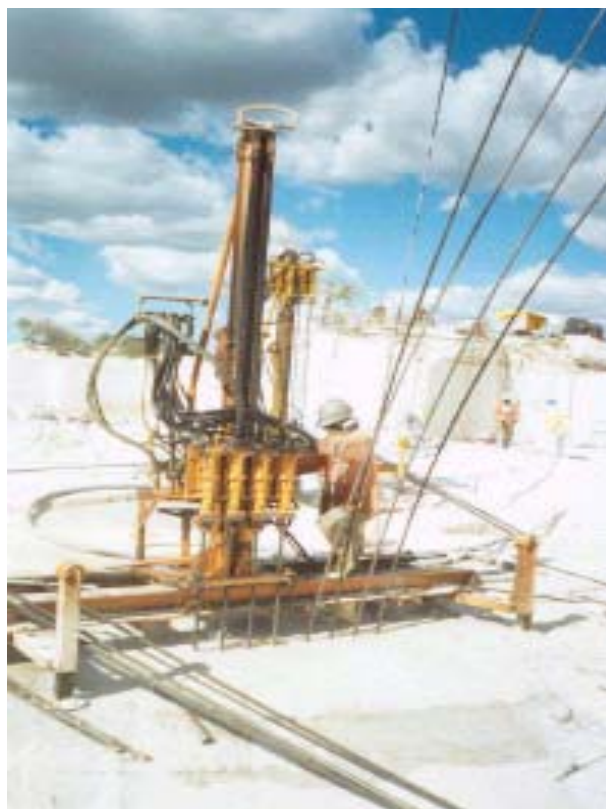
Fig. 18: Operação de perfuração descontínua com uso de “talha bloco” acoplado com quatro marteletes (Fonte: Pinheiro, 2003)
