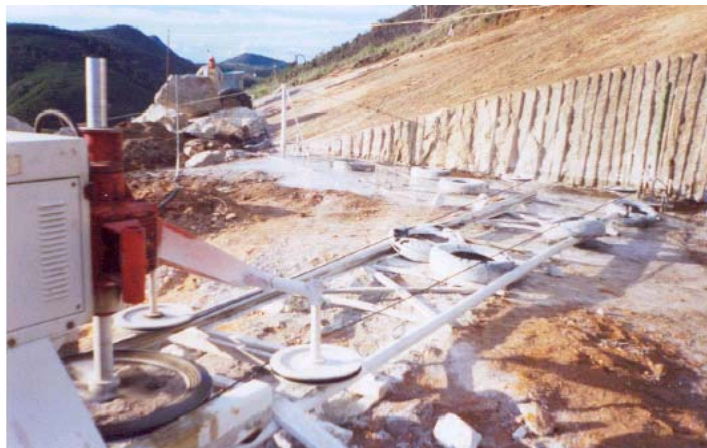
Fig. 13: Corte horizontal através de fio diamantado com sistema de hastes e polias horizontalizadas (Fonte: Pinheiro, 2003)
