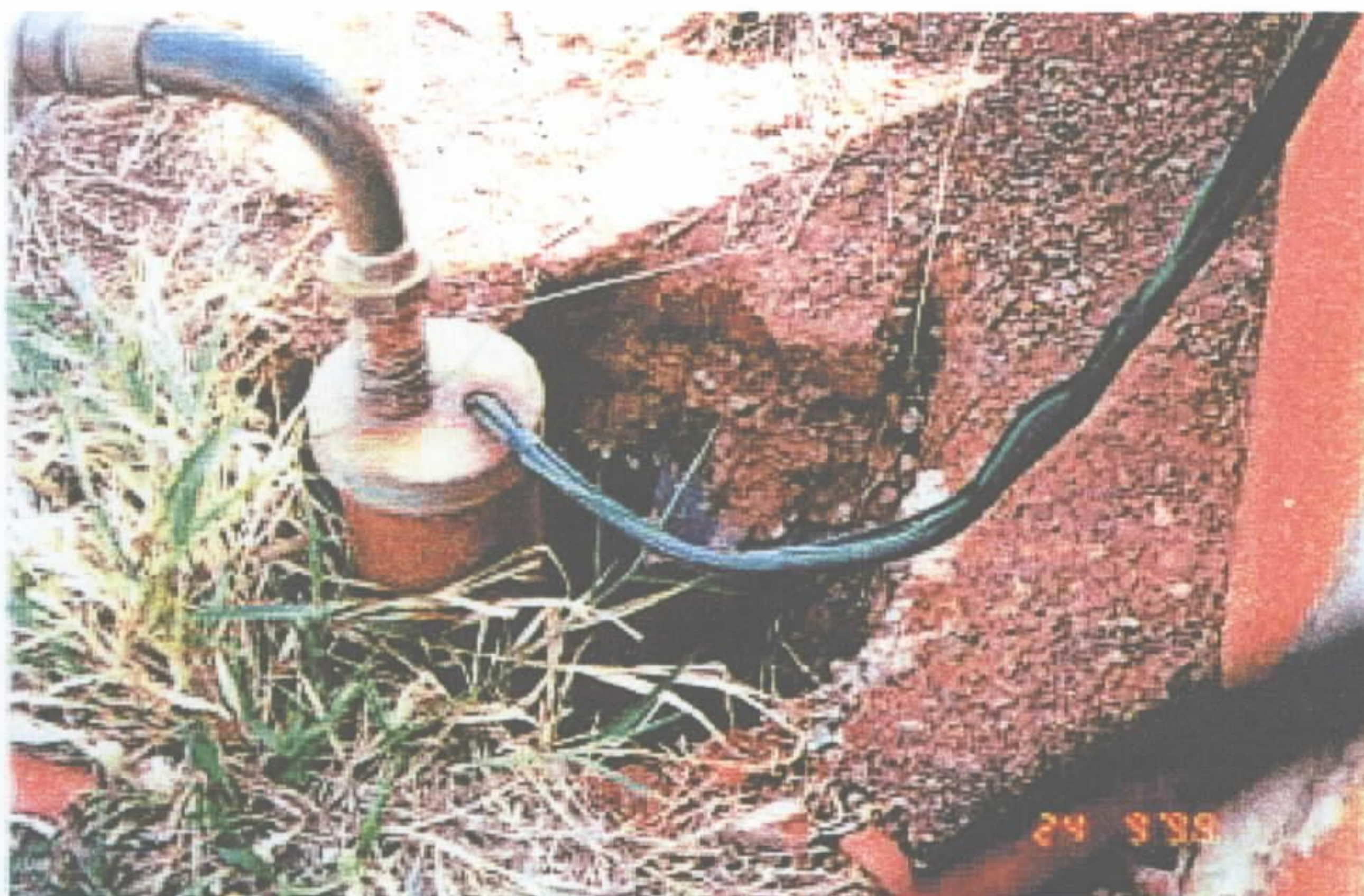
Foto 6 - Poço tubular com risco potencial de contaminação elevado. Em virtude da não cimentação do espaço anelar e a não construção da laje de proteção sanitária ocorreu o solapamento da parede lateral ao revestimento. Esta situação facilita a infiltração de água superficial e contaminantes. Município de Unaí. UTM: 305535E/8147428N.
