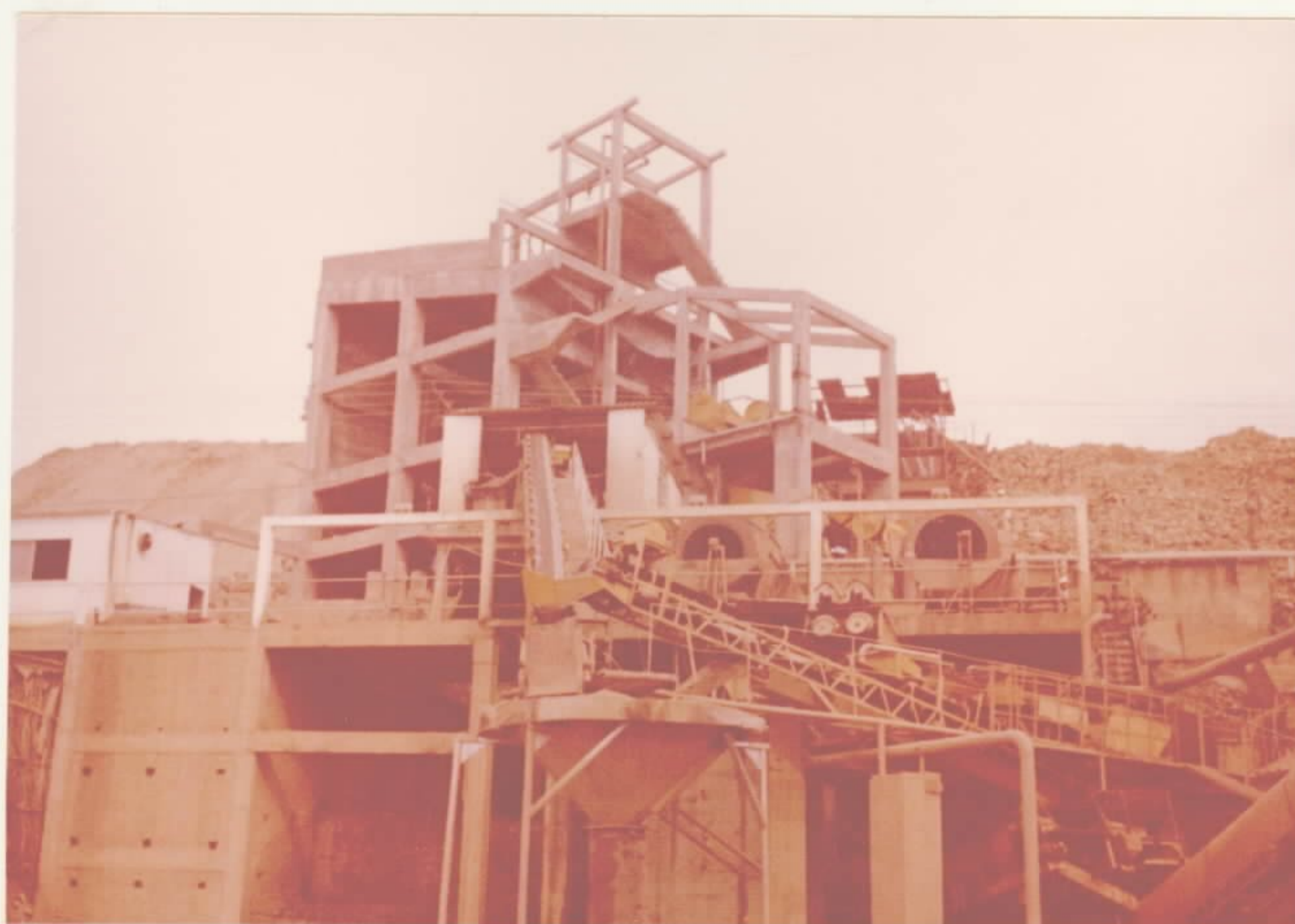
Foto 2 - Instalações do novo circuito de britagem
