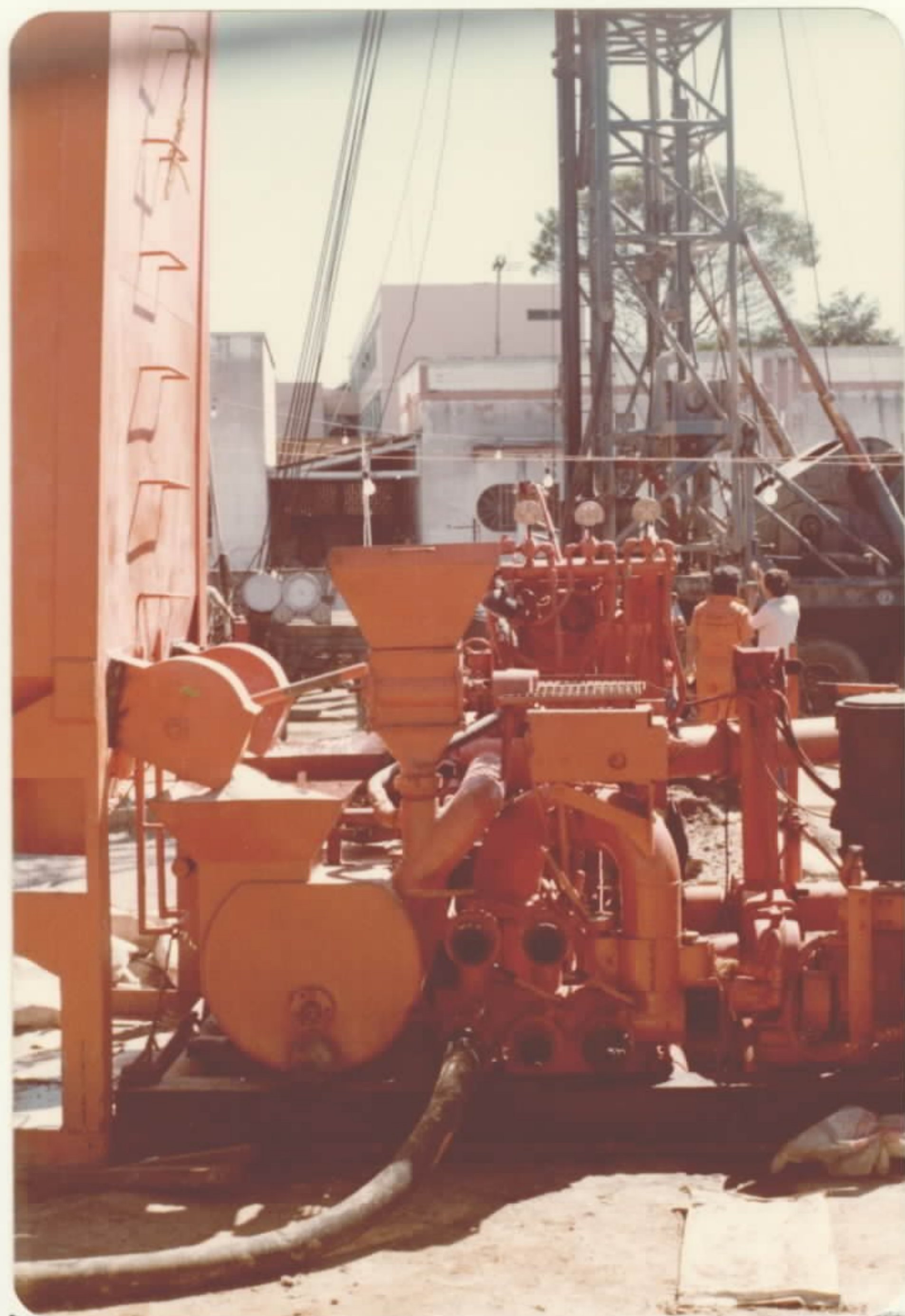
Misturador de fluido de completação e pré-filtro.
