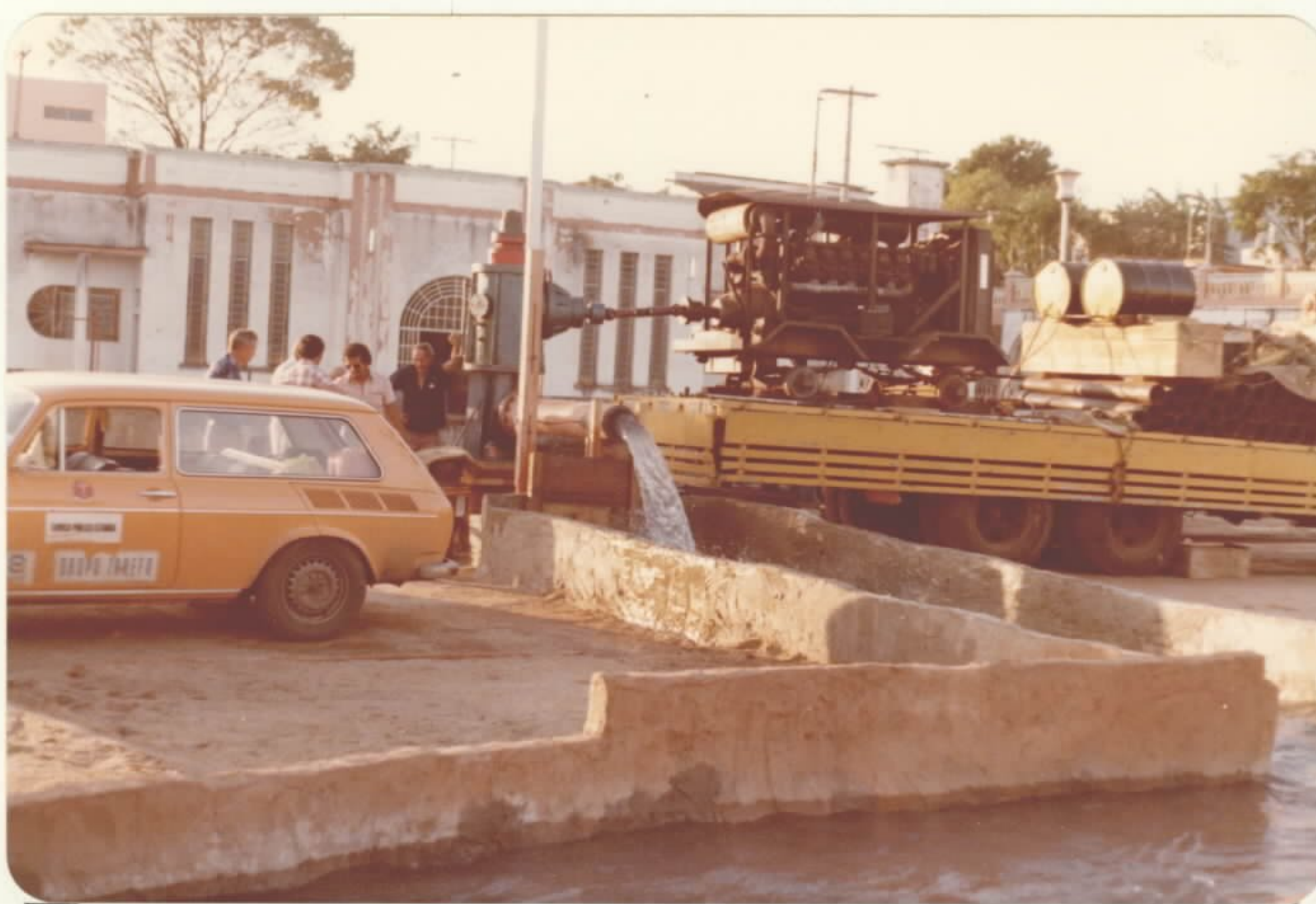
Equipamento de Bombeamento de São José do Rio Preto, no poço 04-RP-01-SP. A pressão e volume d'água desintegrou o sistema provisório de escoamento da foto anterior.
