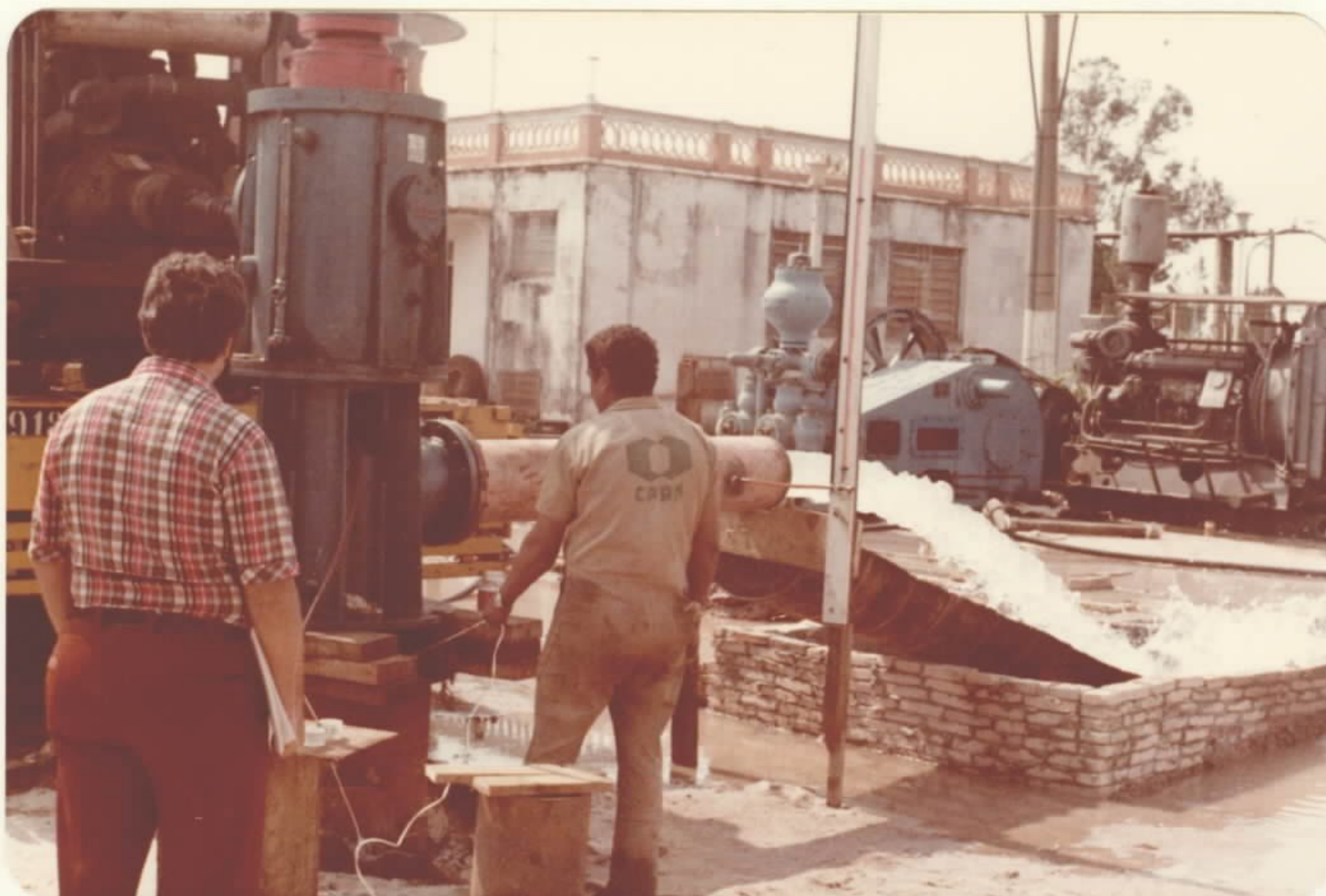
Sistema provisório de escoamento d'água em São José do Rio Preto, no poço 04-RP-01-SP, com a indicação, em vermelho, na régua da vazão do poço.
