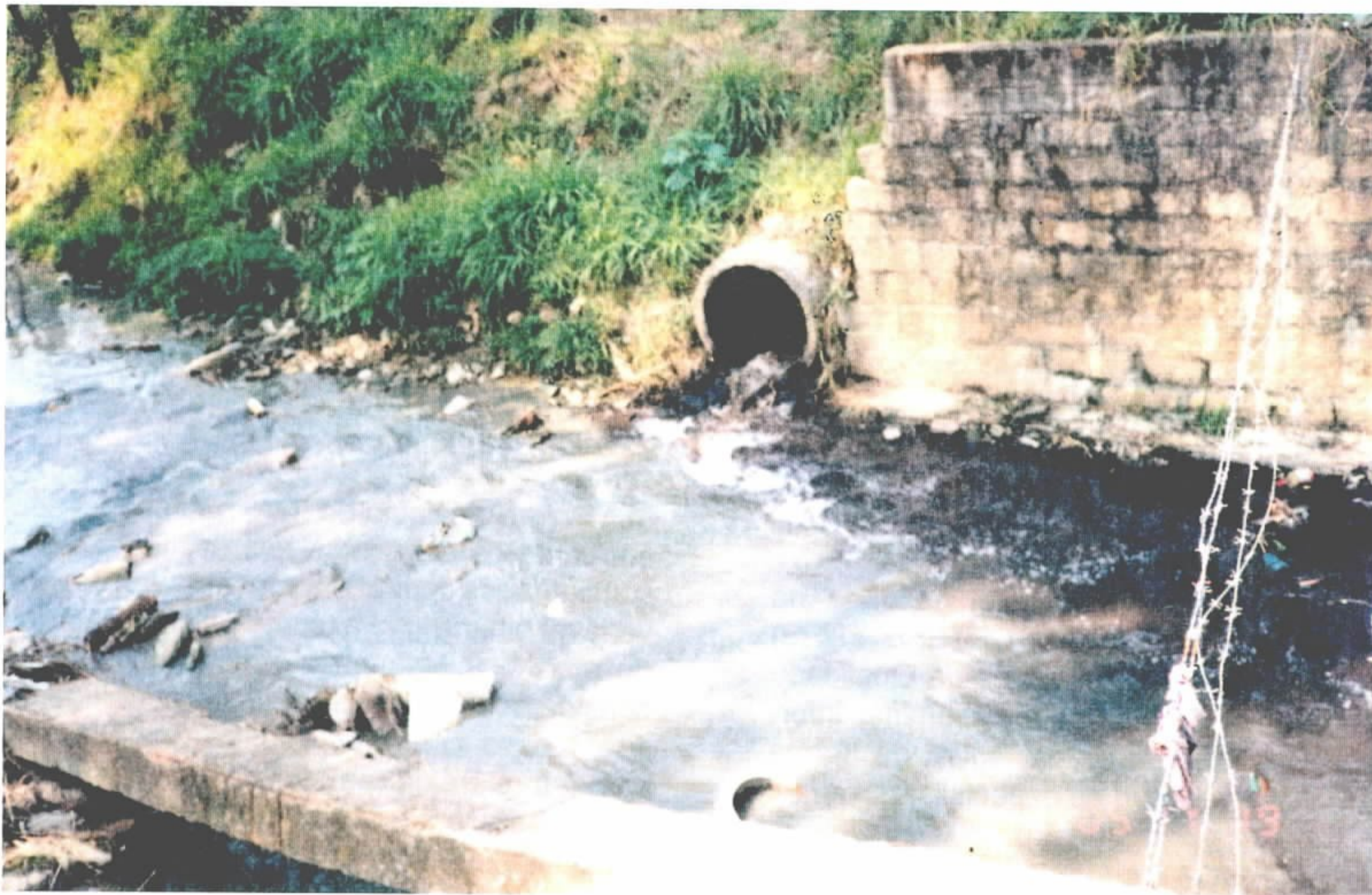
Foto 1 - Intensa contribuição de despejos domésticos, comerciais e industriais. Ponte sobre o rio Criciúma na rua Domênico Sônego.
