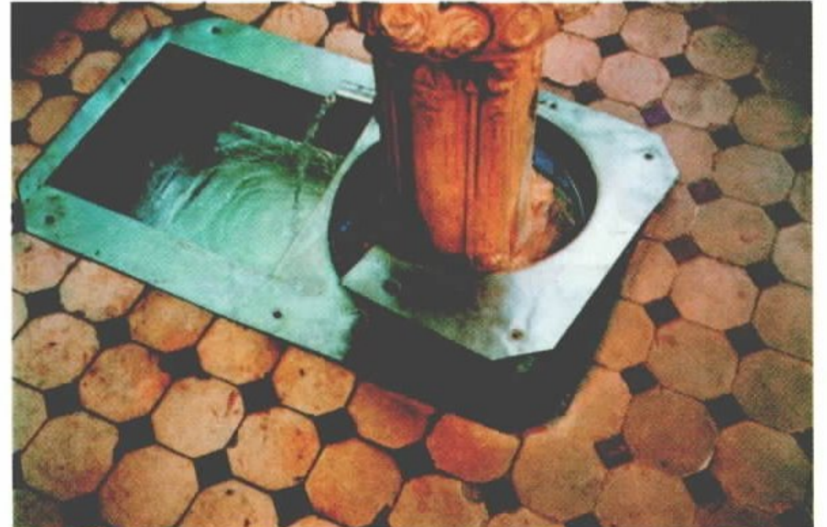
Foto 18 - Detalhe do piso e do entorno do revestimento da captação da fonte Leopoldina.
