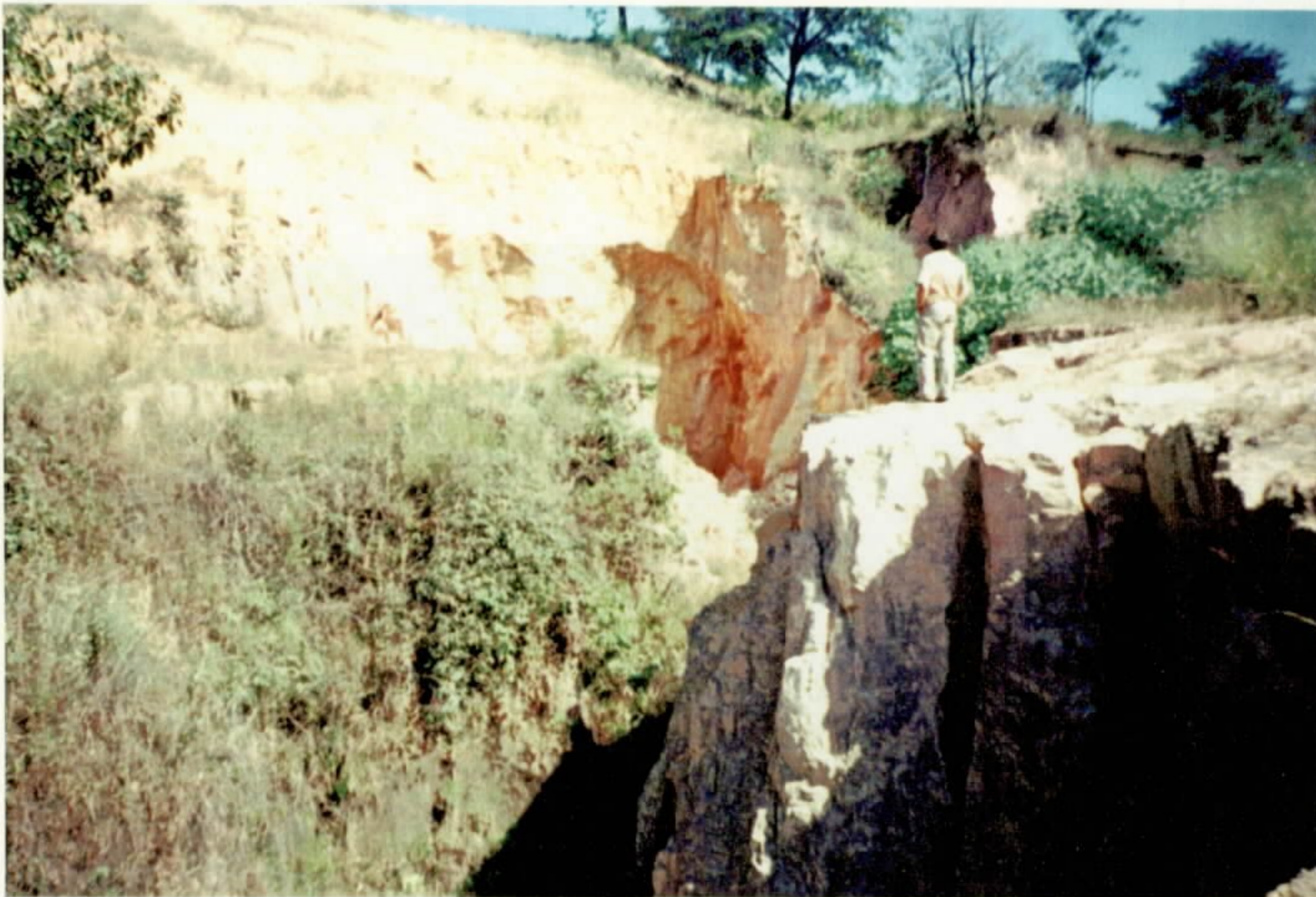
Foto 10: Erosão acelerada. Voçoroca em solo residual de rochas gnáissicas-migmatíticas (Unidade 1). O processo teve início pela retirada de cascalho para cobertura do leito da estrada. Rodovia BR-040/Morro Redondo.
