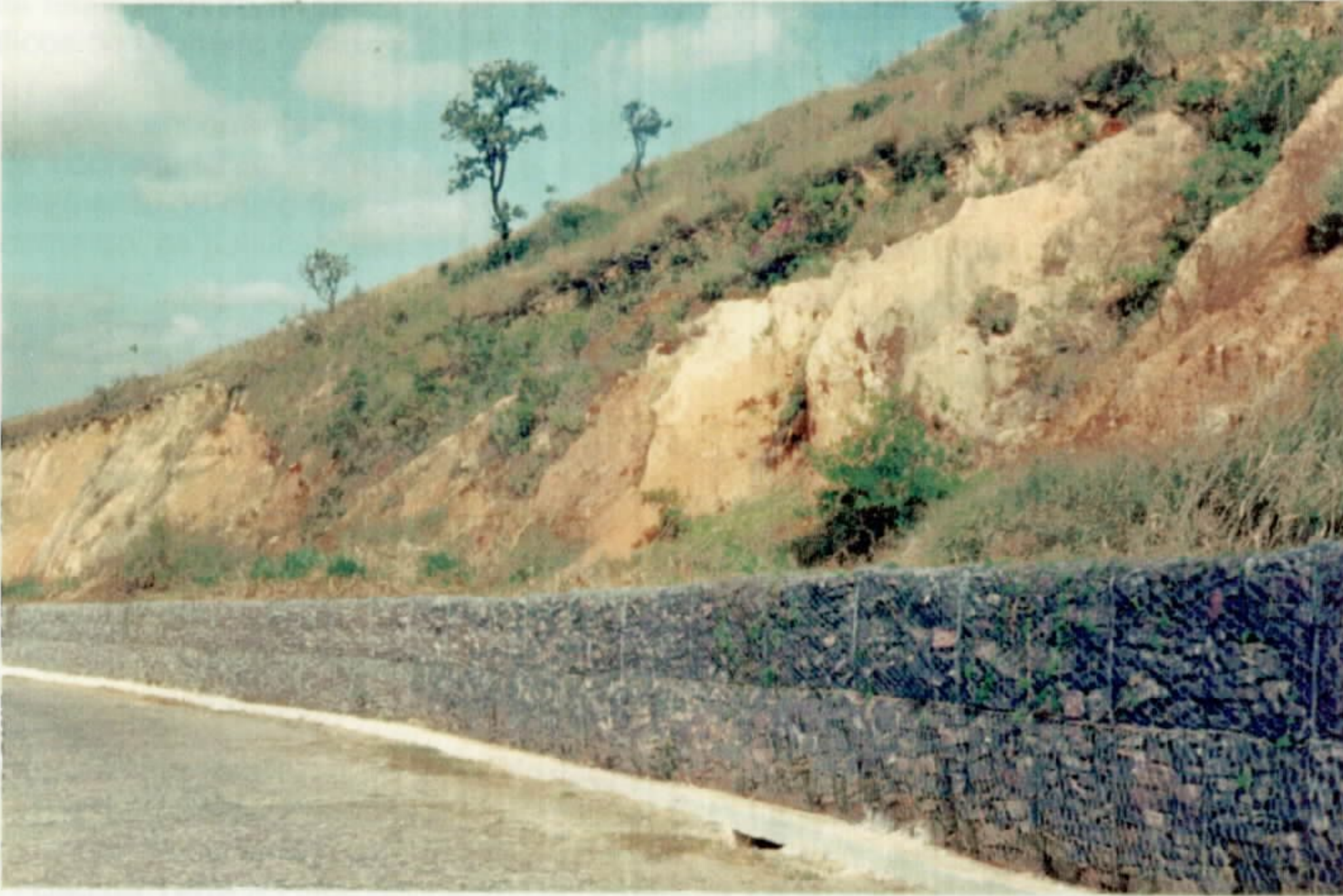
Foto 13: Escorregamento. Em vertentes de alta declividade compostas por solo residual de metapelitos (subzona 3e). Em primeiro plano, proteção realizada através de gabião. Estrada de acesso a Serra de Sta. Helena.
