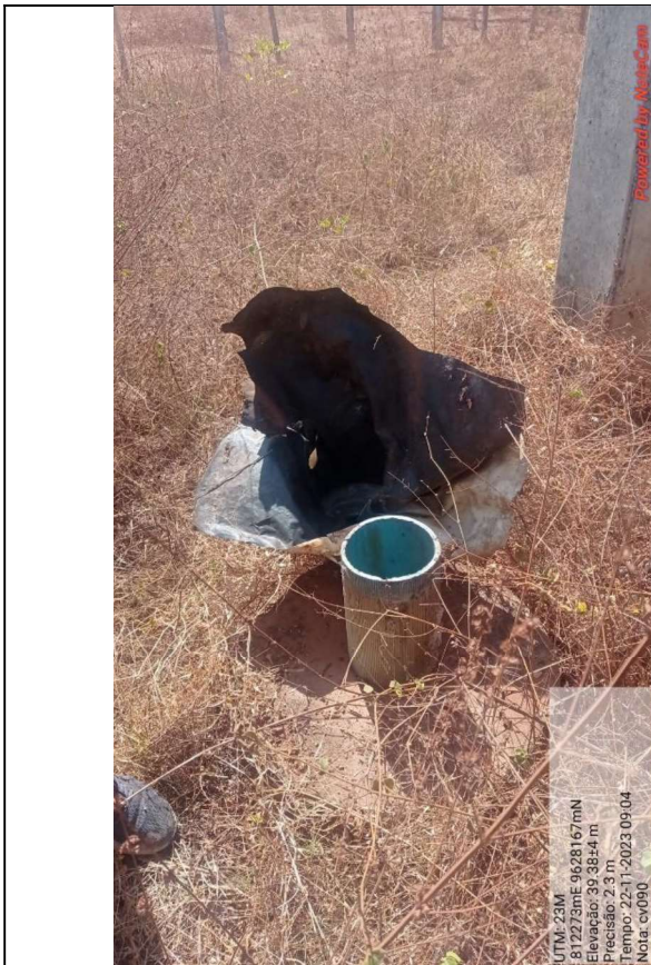
Poço CV 90 – Poço sem tampa, laje de proteção e cercado adequados
