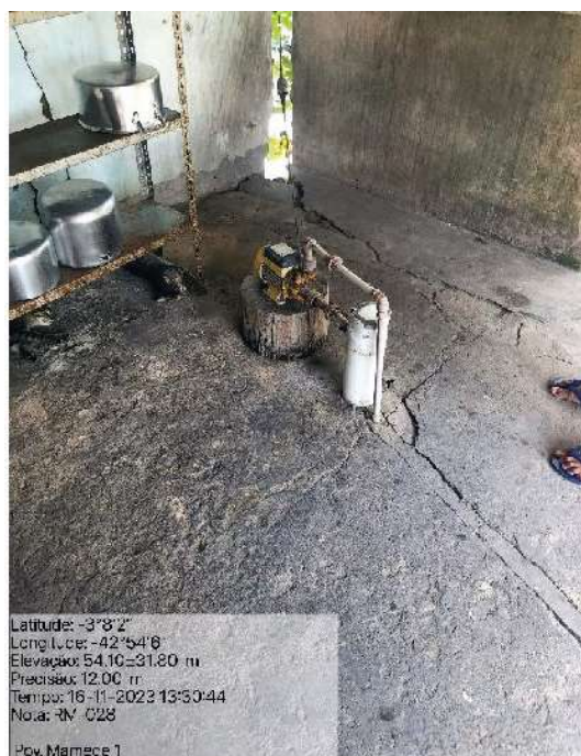
Figura 8 – Tubulação com conexão rosçada.
