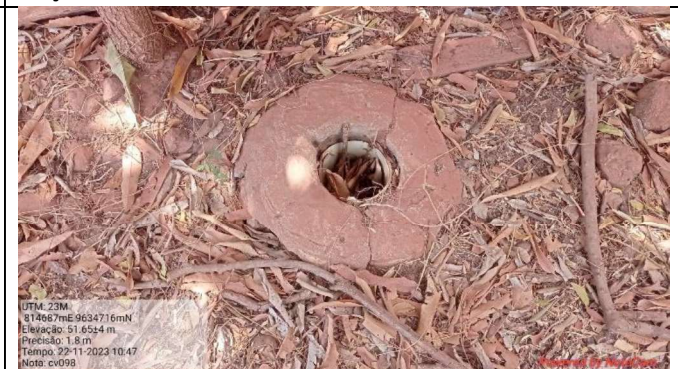
Poço CV 98 – Poço sem tampa e com folhagem dentro
