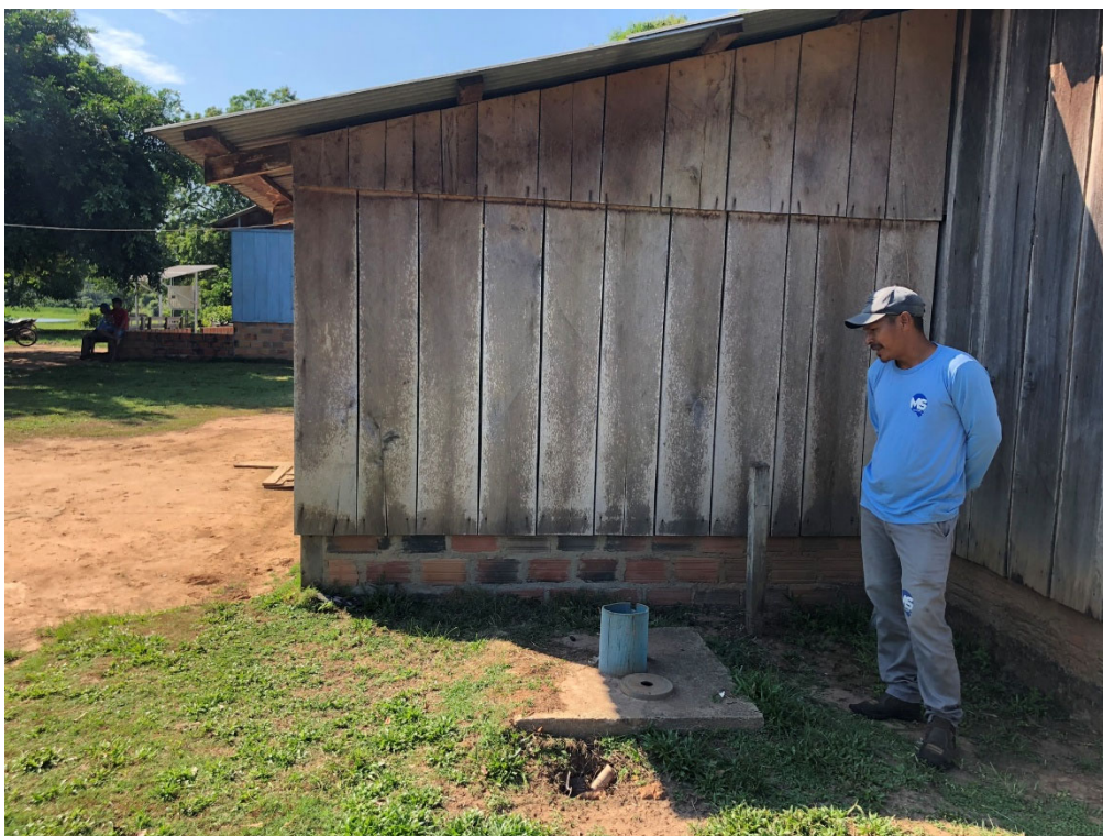
Figura 6: Poço tubular inativo na Aldeia Estaleiro.
