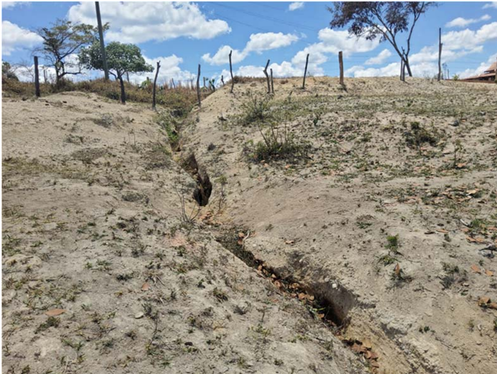
Figura 17 - Sulcos e ravinas formadas no terraço devido a má drenagem superficial.
