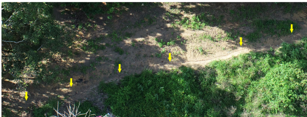
Figura 2: Imagem aérea que ilustra a continuidade e comprimento da trinca (setas em amarelo).
