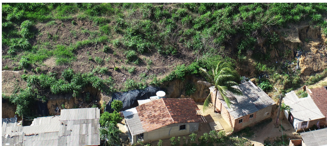
Figura 5: Taludes de corte, na base da encosta, afetados por processos erosivos.
