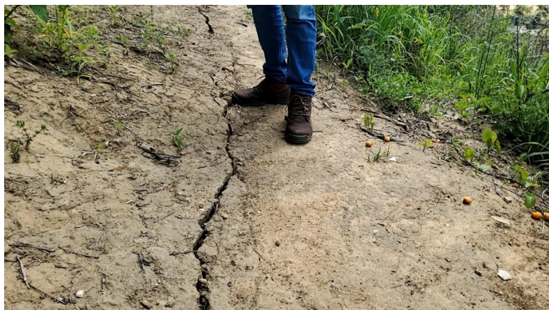
Figura 3: Detalhe da trinca no solo.
