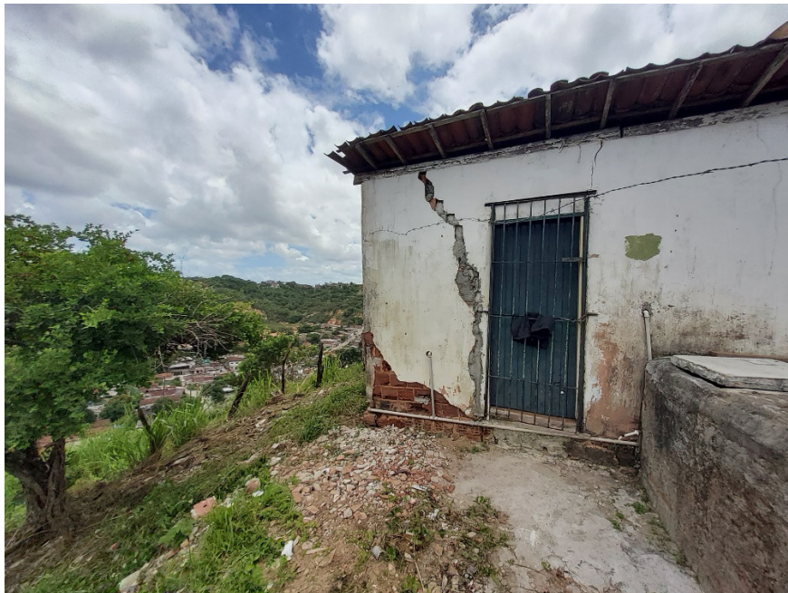
Figura 9: Moradia com fissuras e grande rachadura.
