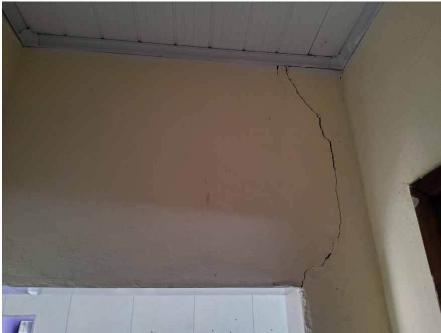
Figura 8: Fissura na parede de moradia.
