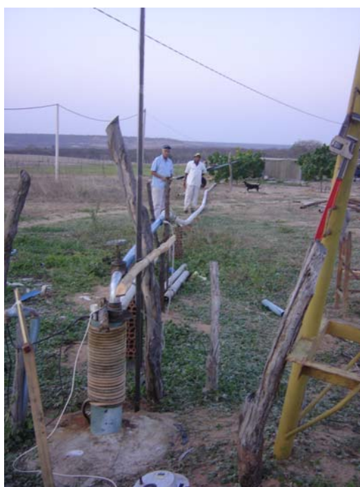
Figura 12 - Visão global do conjunto poço bombeado, tubo escoador de orifício circular com coluna suporte vertical contendo mangueira e escala métrica, e tubos de PVC (Arq.DSC004)
