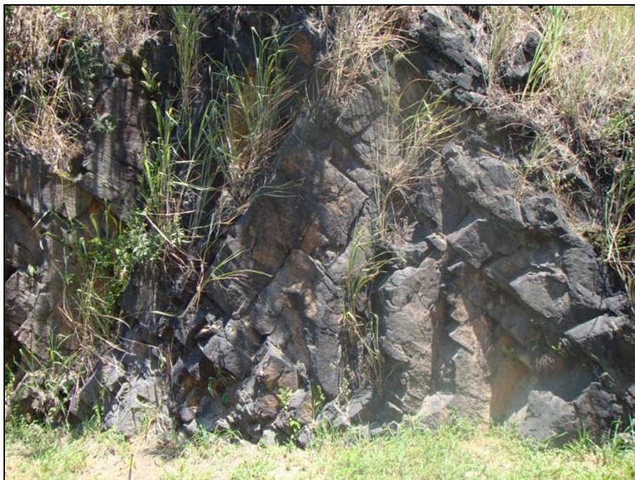
Figura V.5.51 – Detalhe do aspecto de fraturamento do maciço da Ug_Sr_sa.
