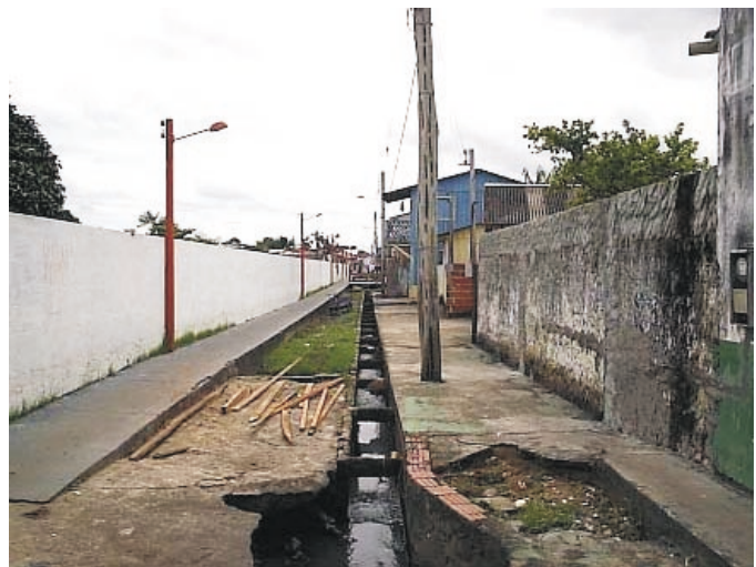
Figura 4 – Vala de esgoto a céu-aberto correndo ao lado do muro do terreno onde estão situados os poços públicos da Estação de Bombeamento Paraíba.
