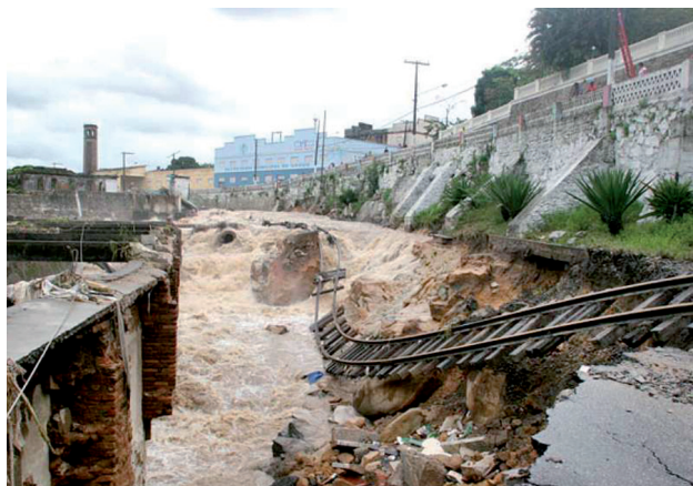
Figura 1.12 - Alagamento em Ponta Verde, na cidade de Maceió-AL, decorrente das fortes chuvas em 2012. Fonte: < http://www.defesacivil.al.gov.br >.
