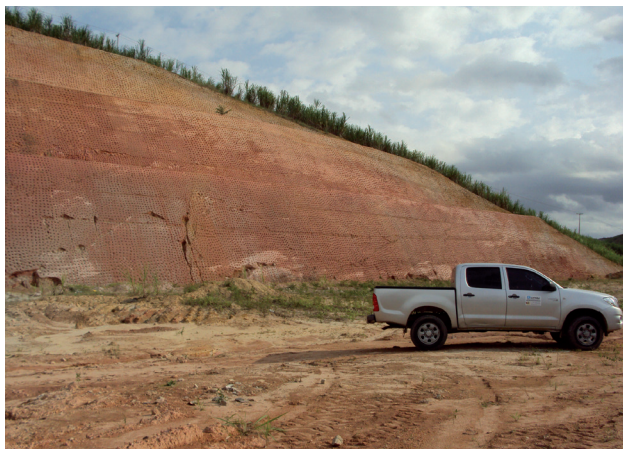
Figura 1.6 - Corte de beira de estrada em afloramento do Grupo Barreiras, com estruturas de contenção parcialmente destruídas e ocorrência de processos de movimentos de massa, nas proximidades da cidade de Satuba-AL. Fotografia: Tereza Bittencourt Villanueva (2011).
