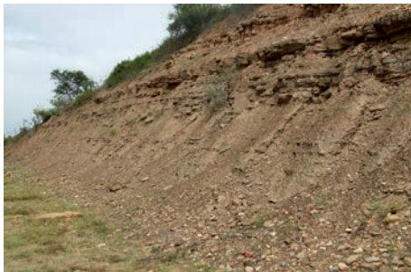
Figura 5.35 – As descontinuidades geomecânicas nessa unidade facilitam a desestabilização em taludes de corte da BR-110 (Ribeira do Pombal, BA).
