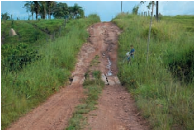
Figura 8.17 – Formação de sulcos em vicinal do município de Rio Maria. Fonte: Coordenadoria de Defesa Civil do Estado do Pará (CEDEC-PA).
