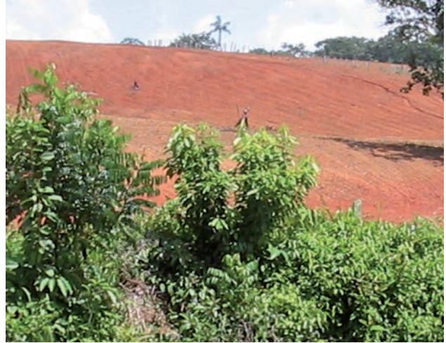
Figura 9.15 – Sulcos (erosão laminar) em latossolo concrecionário (rodovia BR-364, próximo à vila Jaci-Paraná).
