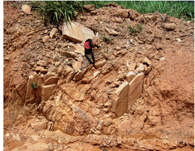
Figura 9.6 – Granitos fraturados (rodovia RO-357).
