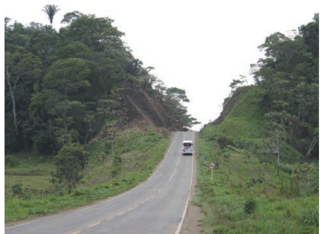
Figura 12.191 – Corte em rocha na rodovia BR-364, sendo comum a instabilidade de taludes observada ao fundo.
