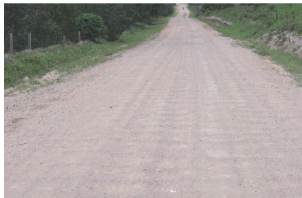
Figura 12.121 – Pavimento de estrada arenoso, derivado da erosão de arenitos da formação Palmeiral (rodovia BR-429, vila Terra Boa).
