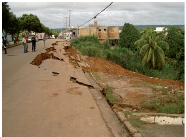
Figura 9.3 – Deslizamento em Porto Velho.
