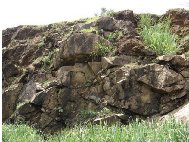
Figura 12.192 – Monzogranito fraturado, com risco de queda de blocos (rodovia BR-364).
