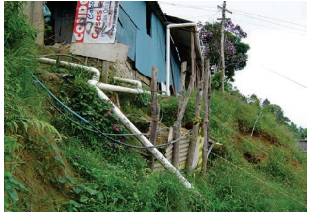
Figura 9.2 – Lançamento de esgoto em área urbana, comum em Porto Velho, às margens do rio Madeira.
