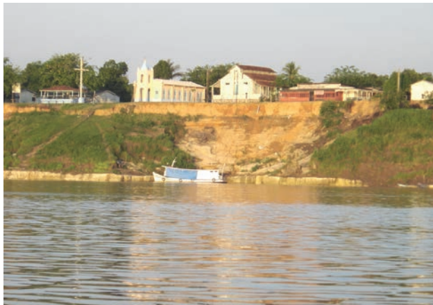
Figura 3.9 – Desbarrancamento de talude do terraço fluvial do rio Madeira junto ao núcleo urbano de vila Calama; risco geológico associado a fenômenos de erosão fluvial – “terras caídas” (próximo à confluência do rio Madeira com o rio Ji-Paraná (ou Machado).
