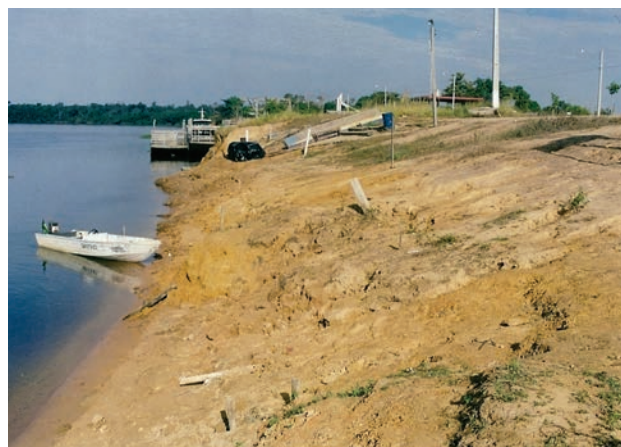
Figura 1.7 – Orla fluvial da cidade de Pimenteiras, situada em margem côncava do rio Guaporé, submetida a forte erosão fluvial.
