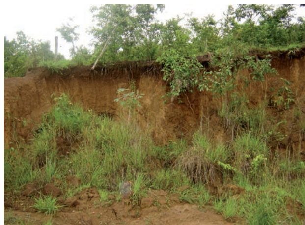
Figura 12.152 – Instabilidade de talude (rodovia RO-383, Alta Floresta d'Oeste).
