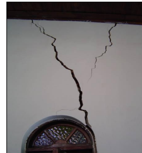
Rachaduras nas paredes
