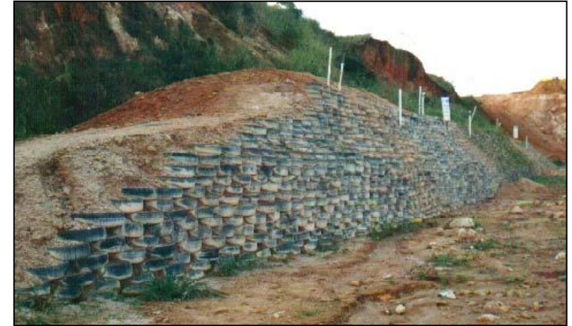
Muro de contenção formado com pneus usados, amarrados uns aos outros e preenchidos com solo.
