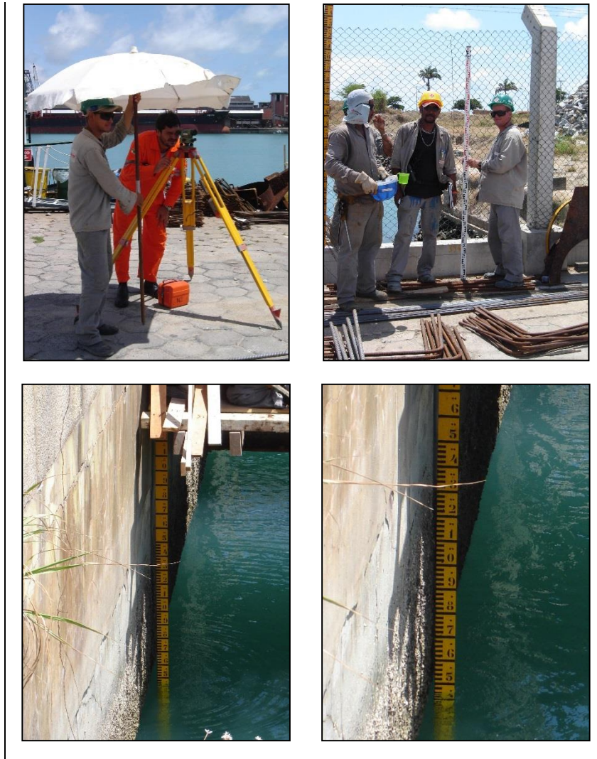
Figura 3. Nivelamento geométrico da estação maregráfica instalada no Porto de Maceió.
