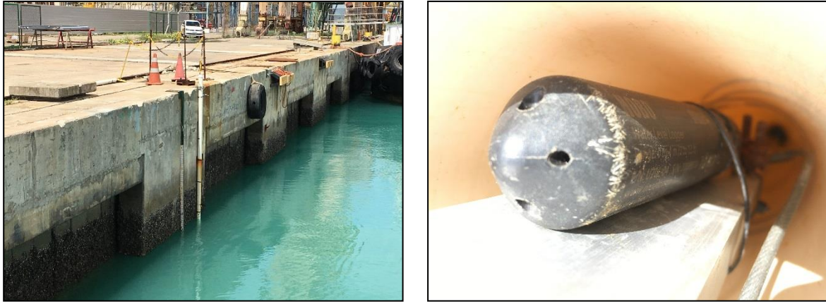
Figura 4. Instalação do marégrafo digital da marca HOBO modelo U20L-04 capaz de medir amplitude de maré de até 4 metros.
