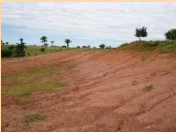
Fotografia 16: Processo de ravinamento em área explorada para retirada de argila, vista para Noroeste, estação AL-13.
