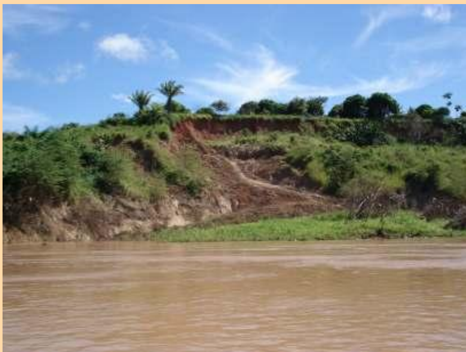
Fotografia 12: Deslizamento de encosta a margem esquerda do rio Acre localidade do Panorama, próximo à foz do Igarapé São Francisco, AL-09.
