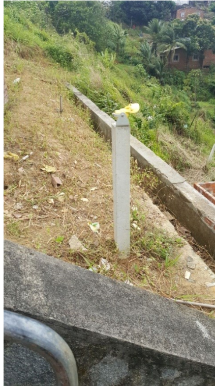
Figura 18. Prisma de monitoramento instalado pelo CEMADEN.
