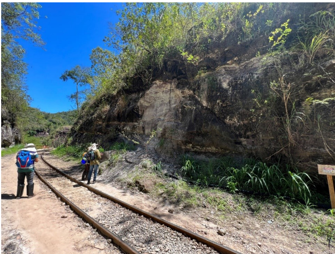
Figura 57 - Cicatriz em maciço rochoso às margens da Ferrovia Centro-Atlântica, evidenciando processo de desestabilização recém-ocorridos.
