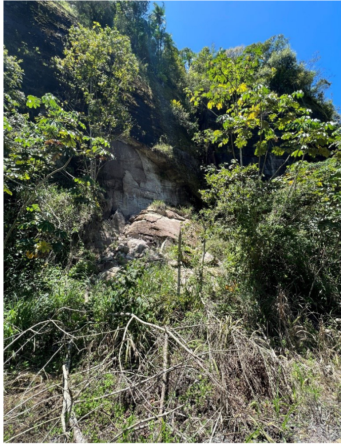
Figura 58 - Cicatriz em maciço rochoso às margens da Ferrovia Centro-Atlântica, evidenciando processo de desestabilização recém-ocorridos. Notar grande volume de material mobilizado na base da escarpa.
