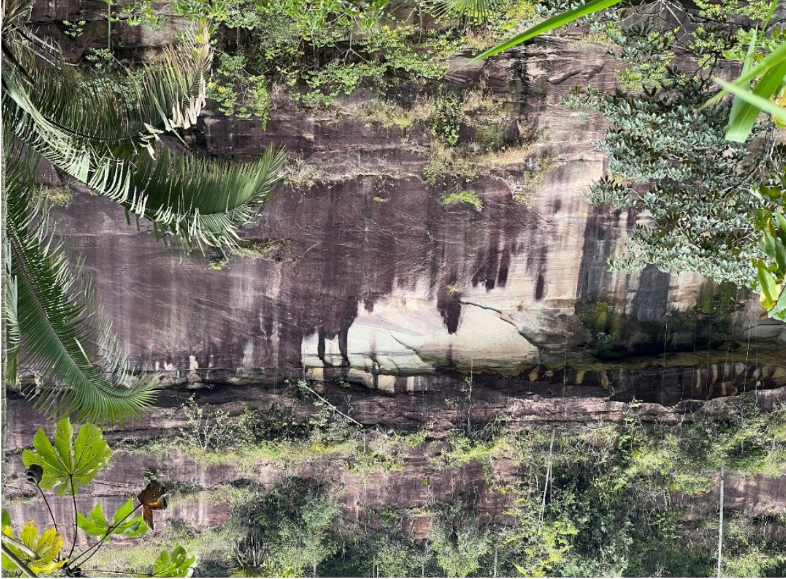
Figura 50 - Cicatriz de deslocamento condicionado por estratificação horizontal no maciço rochoso.
