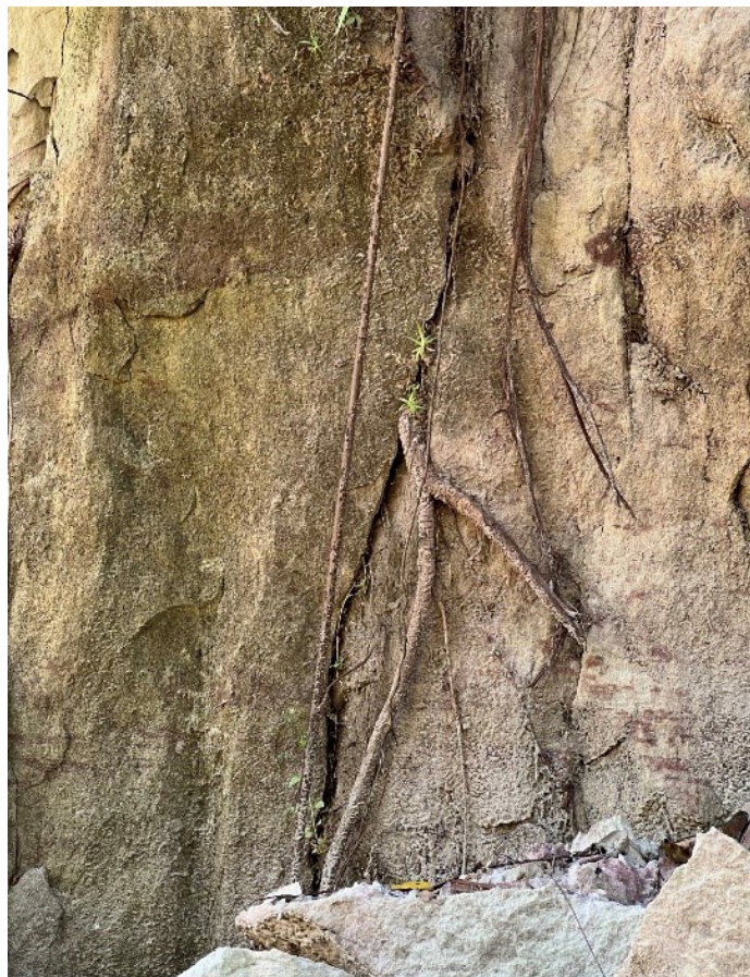
Figura 60 - Detalhe flagrado no maciço ilustrado na figura 59, mostrando o crescimento de raízes ao longo das fraturas existentes no maciço rochoso, fato que pode favorecer o desprendimento de blocos de rocha.
