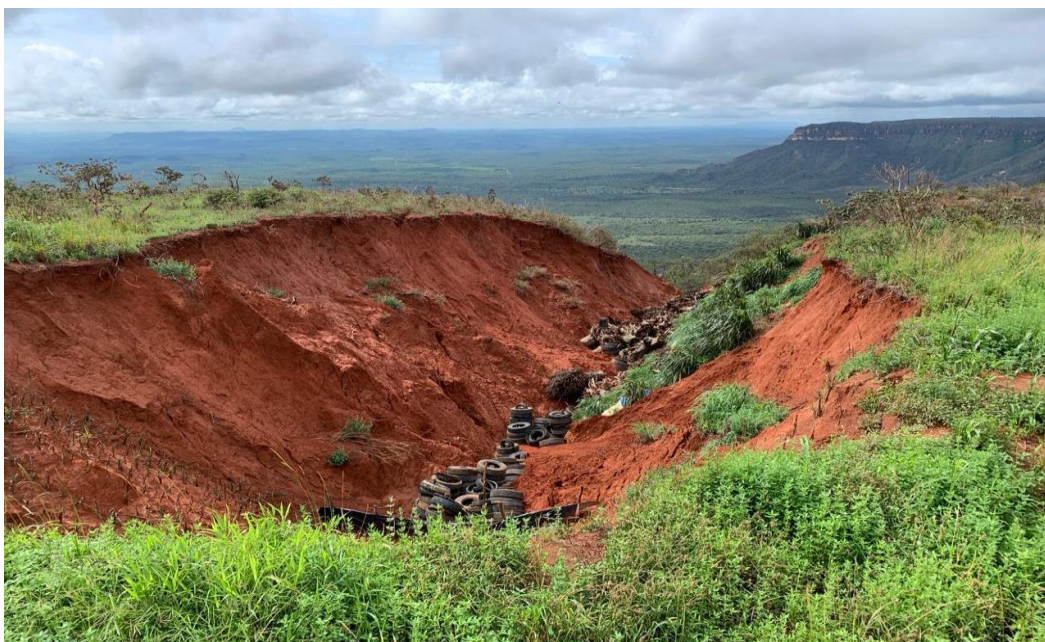
Figura 18: Pneus e entulhos lançados na erosão. Fonte: foto dos autores.
