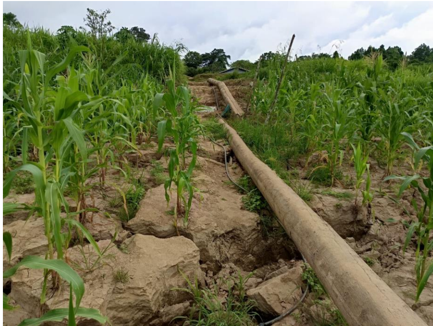
Figura 17: Degráus de abatimento junto à barranca da comunidade indígena de Santo Antônio do Catipari, adjacente à desembocadura do furo. Fonte: Autores.
