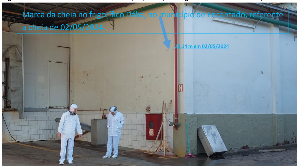
Figura 6. Local da marca de cheia de 02/05/2024, no frigorífico em Encantado /RS.
