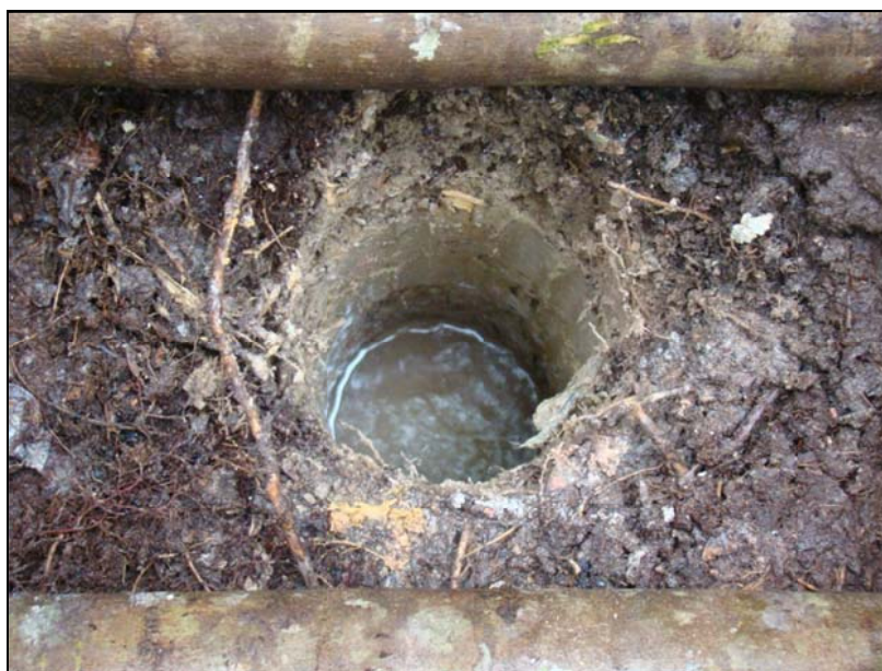
Figura 8: Coluna d'água no furo AMT-04 gerada a partir da infiltração contínua, pelas paredes do furo, das águas de chuva acumuladas na superfície do terreno.
