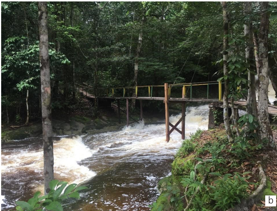
Figura 21 - Cachoeira do Santuário. Maciço rochoso com estratificação sub-horizontal. Risco de queda de blocos e deslocamento de rocha (a). Ponte de acesso com estrutura precária e guarda corpo lateral vazado (b). Recomenda-se sinalização e manutenção na ponte.
