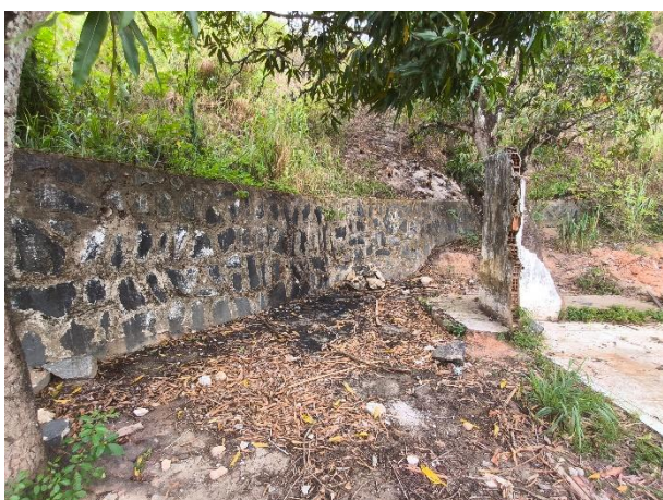
Figura 3: Porções do muro de contenção localizado na parte central do setor PE_CAMARAG_SR_026_CPRM.
