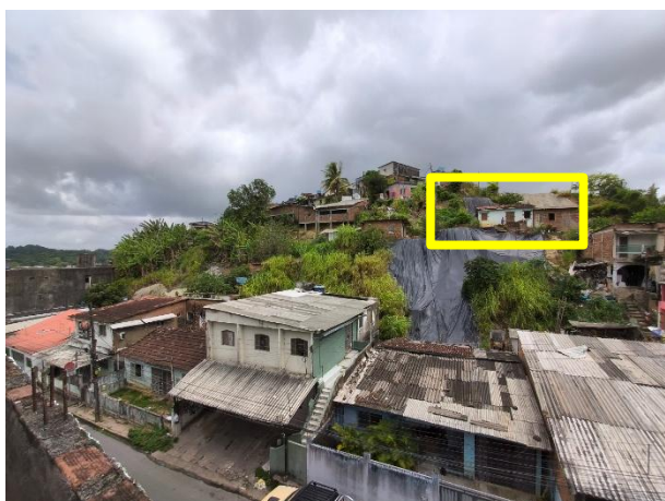
Figura 7 – Visão da área afetada pela ocorrência de sumidouros, parcialmente protegida por lonas plásticas com a finalidade de reduzir danos durante períodos chuvosos. Observa-se a presença de vegetação ao longo do talude, nas proximidades da Avenida Pernambuco, na porção oeste do setor PE_CAMARAG_SR_026_CPRM.
