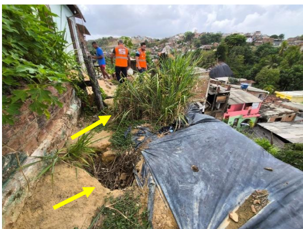
Figura 5: Visão do local afetado pela ocorrência de sumidouro na encosta, com a identificação de dois pontos distintos: o primeiro localizado na porção central da imagem e o segundo junto à faixa de vegetação que delimita a residência e o terreno desocupado. Ambos os pontos situam-se ao longo da linha da encosta, na porção oeste do setor PE_CAMARAG_SR_026_CPRM.
