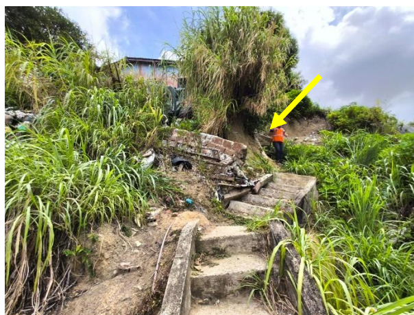
Figura 6 – Escadaria de acesso destruída, associada à ausência de sistema adequado de escoamento das águas pluviais, condição que possivelmente contribuiu para o desenvolvimento dos processos erosivos observados. A porção destacada corresponde ao trecho onde a escadaria se encontra ausente, situado na parte oeste do setor PE_CAMARAG_SR_026_CPRM.
