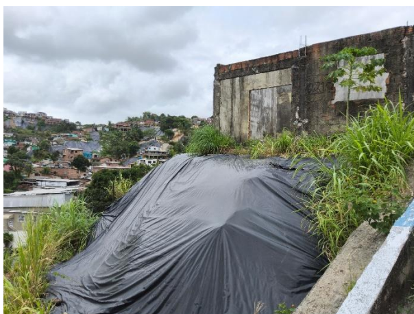
Figura 8 – Rua Amendolândia, trecho caracterizado pela presença de muro de contenção implantado na encosta, situado muito próximo à edificação vizinha, com proteção provisória por lona na crista de parte do talude. O local integra a porção leste do setor PE_CAMARAG_SR_026_CPRM.
