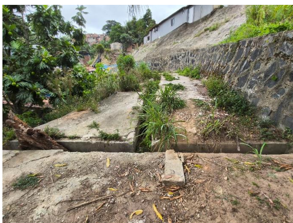
Figura 4: Muro de contenção localizado abaixo de uma casa, no qual distinguem-se fissuras.
